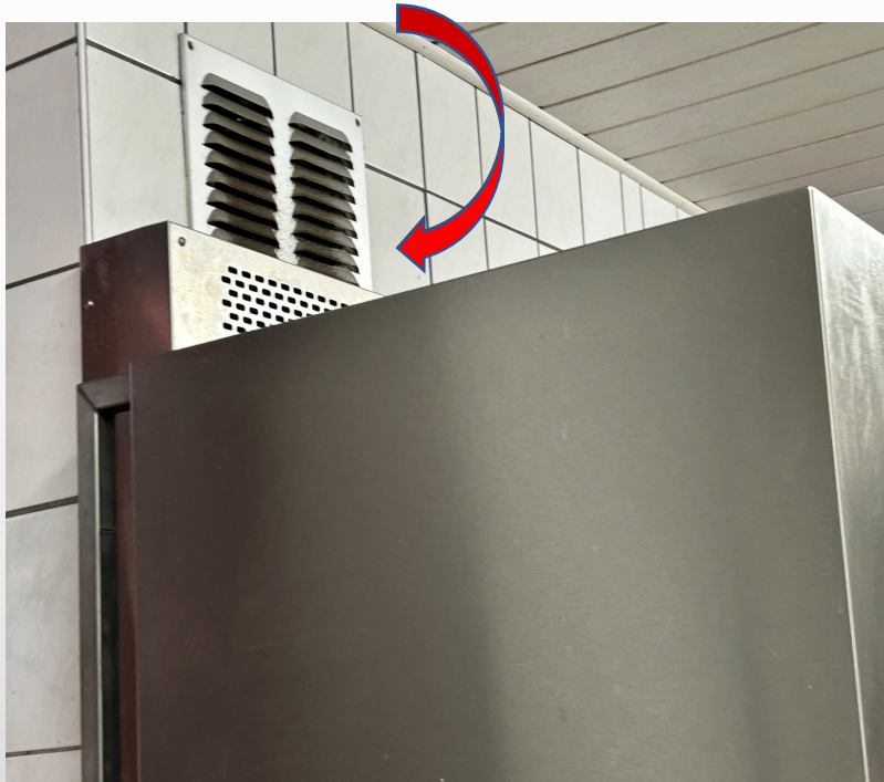
stark verschmutzter Lüfter in der Spülstrecke
